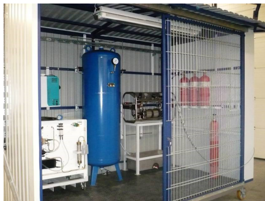
A félig nyitott konténerbe telepített hidrogéntöltő állomás
